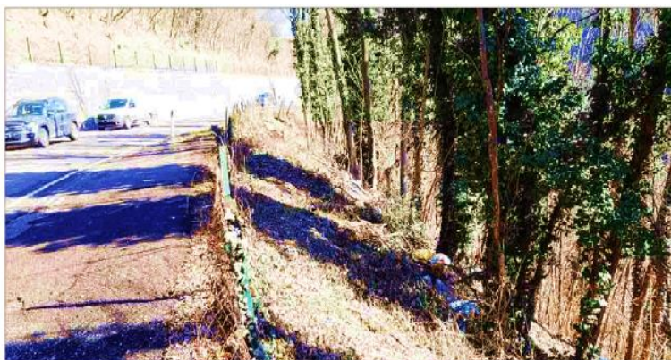
La strada provinciale 204: in alcuni tratti manca il guard rail di protezione e si notano rifiuti nella scarpata
